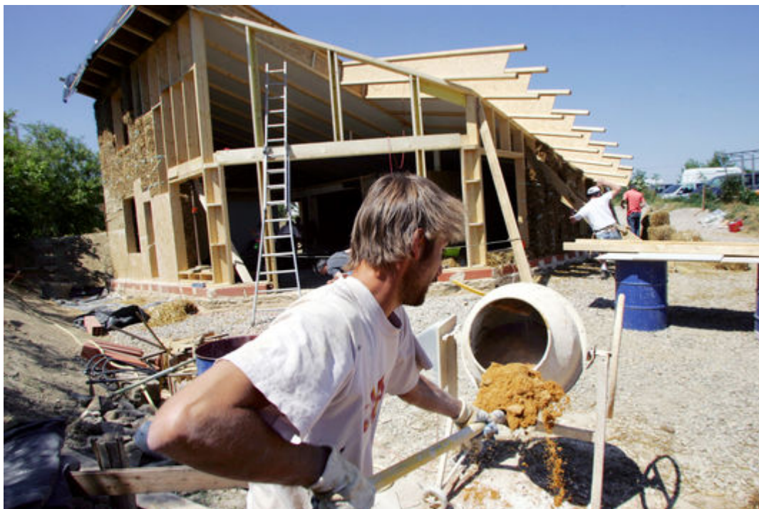
Chantier de construction d'une maison bioclimatique à Athée (Côte-d'Or) : des bottes de pailles servent d'isolant. ANDRE DURAND / AFP
